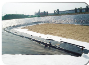
生活垃圾填埋场改扩建 封场覆盖、库底防渗、渗滤液处理、填埋气导排
